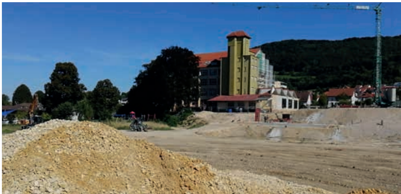
Ansicht des Geländes vor Baubeginn. Die Vorbereitung des Geländes hat im Sommer 2019 begonnen.
